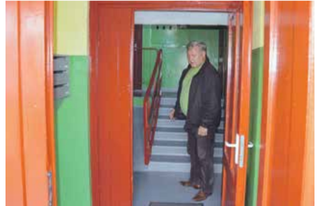
Kuldīgas novada Domes priekšsēdētājas vietnieks Aleksandrs Lange novērtē Vārmes pagasta „Akācijas” mājas restaurētās durvis.
