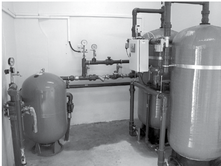
Sermītes ciemā, lai uzlabotu ūdens kvalitāti, izbūvētas atdzelzošanas iekārtas.
