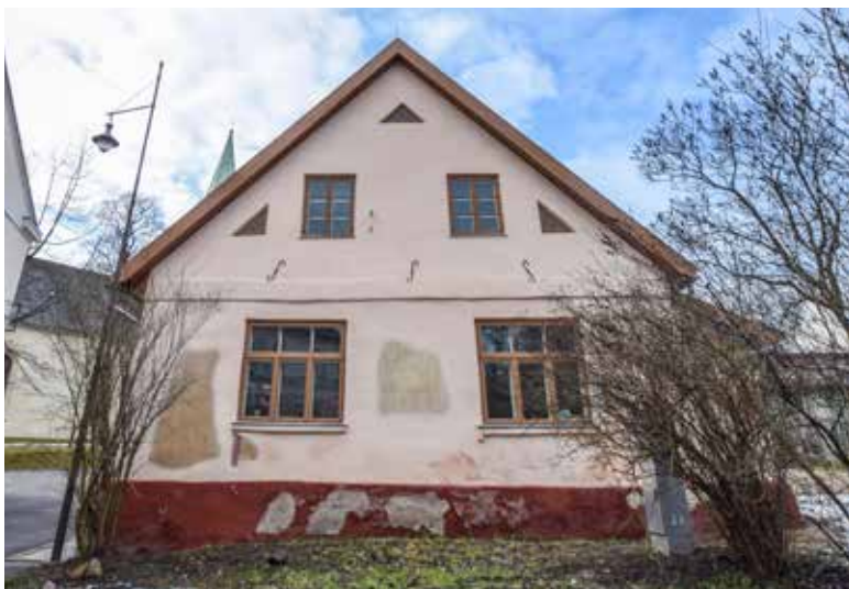
195. attēls. Baznīcas ielā 30 sarkani krāsoto ēkas cokolu ietekmē sāls šķīduma nokļūšana uz ēkas fasādes. Ričarda Sotaka foto, 2019.
